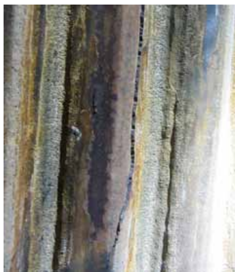
图 1 水冷壁高温硫化物腐蚀表面形貌
